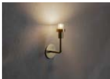
n22 parete con braccio
